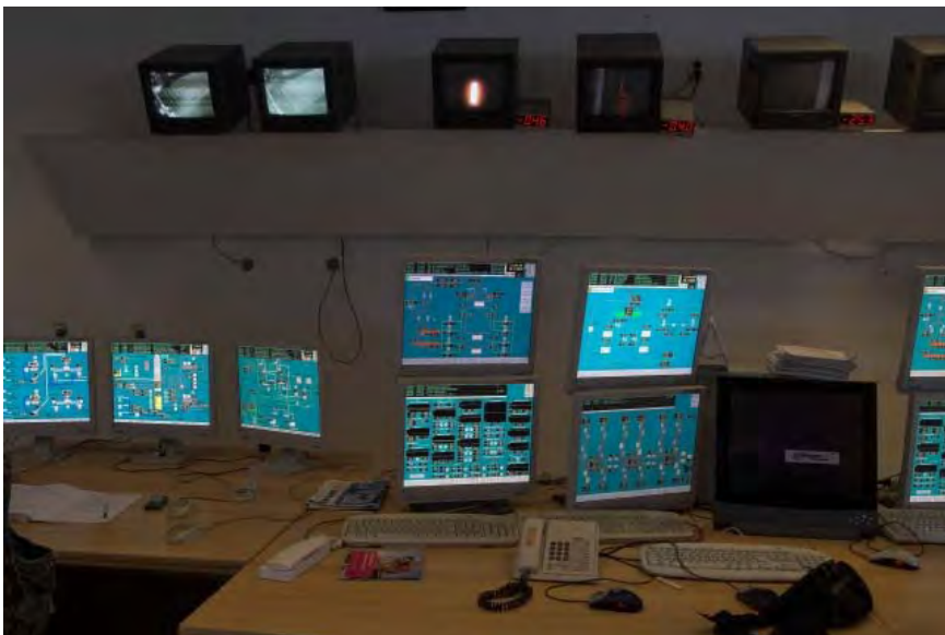
Central Control Room in Mělník CHP Plant
