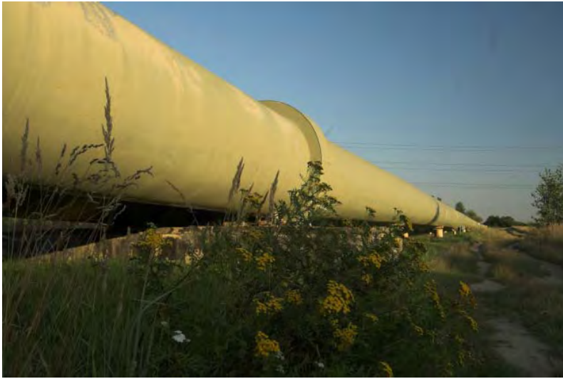
Backbone Feeder from Mělník CHP Plant (2 x DN 1200)
