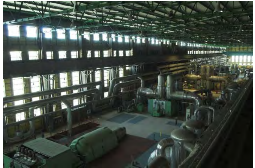
Turbine Hall in Mělník CHP Plant
