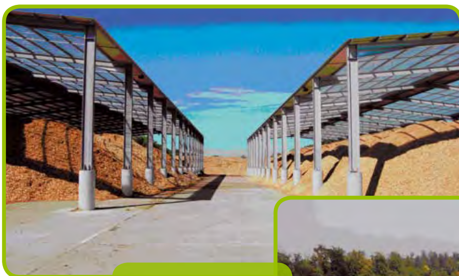
Plate-forme de traitement de la biomasse
